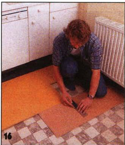
16 Чтобы избежать совмещения швов между плитами смежных рядов, укладку каждого последующего ряда начинают с укладки обрезанной плиты предшествующего. Швы должны быть взаимно смещены как минимум на 40 см.
