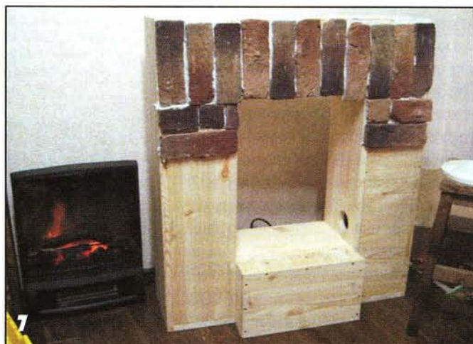
7 Дополнительный выступ пришлось приделать к коробу портала, чтобы между полукруглой декоративной решёткой и порталом не было большой щели.
